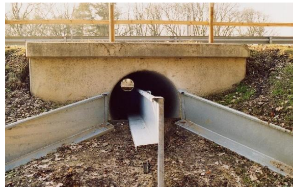
Figura 12. Cercas com a extremidade superior dobrada para evitar fuga de animais para a pista, direcionando para túnel de sapos. Foto: editada de Christian Fischer, obra original sob licença CC BY-SA 3.0 ( http://creativecommons.org/licenses/by-sa/3.0/ ), via Wikimedia Commons.
