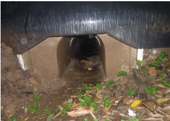
Figura 26. Túnel climático em concreto polímero para anfíbios com cercamento na Rota do Sol/RS. Foto: Caroline Zank.
