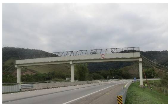
Figura 31. Passagem superior de fauna com múltiplas cordas ligadas às árvores da vegetação do entorno na BR-101/RJ. Foto: Helio Secco.
