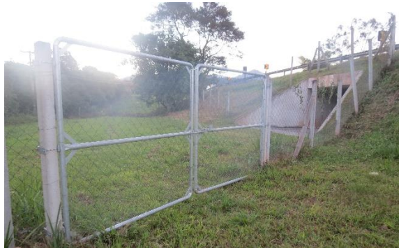
Figura 8. Portão de acesso instalado em cercamento associado à passagem de fauna na BR-101/RJ. Foto: Helio Secco.
