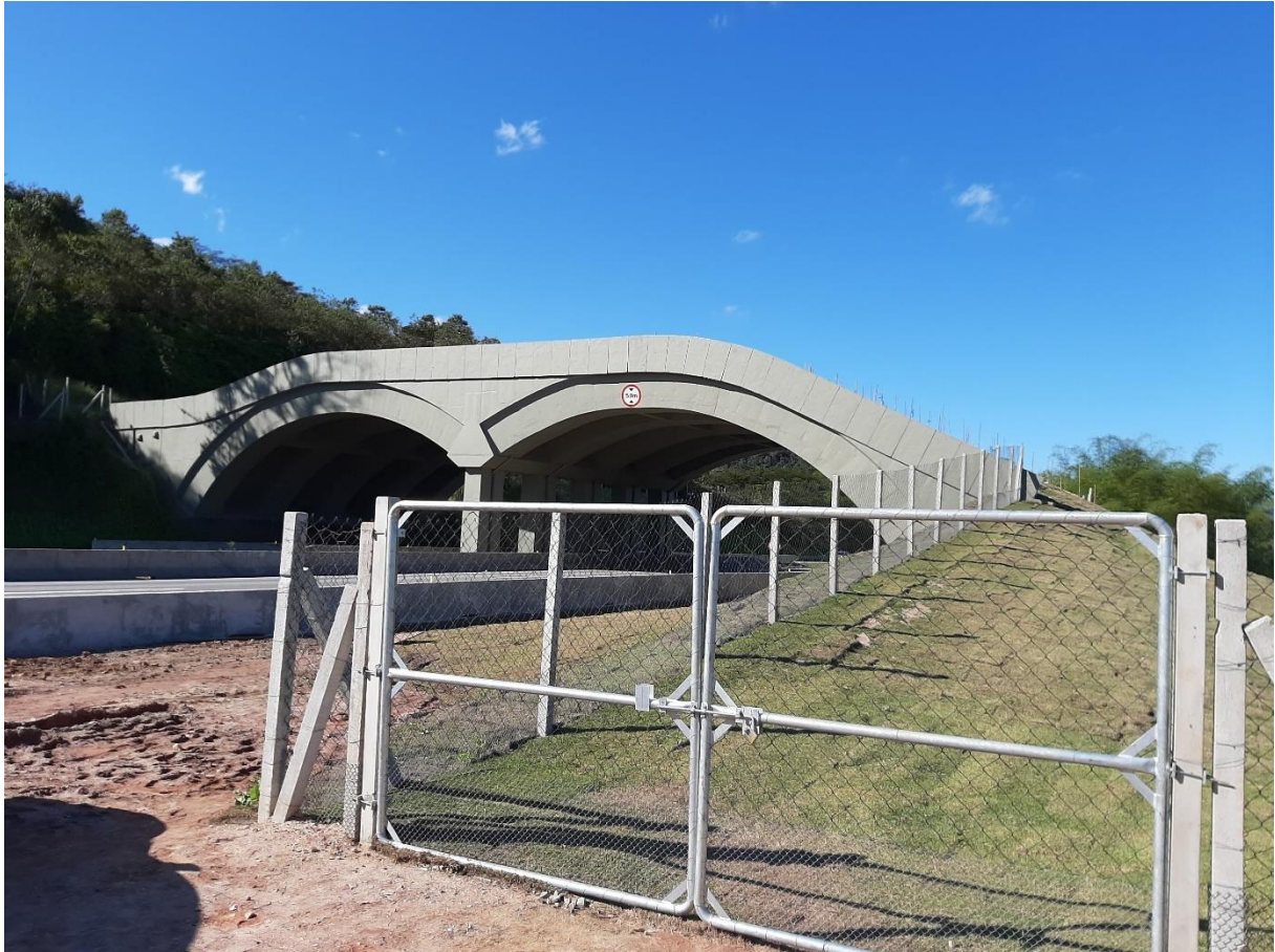
Figura 35. Cercamento com portão de acesso ao viaduto vegetado sobre a BR-101/RJ. Foto: Helio Secco.
