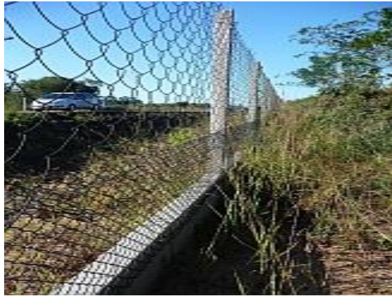
Figura 6. Cerca com base em concreto e tela em malhas progressivas na BR 101/RS. Foto: Mozart Lauxen.
